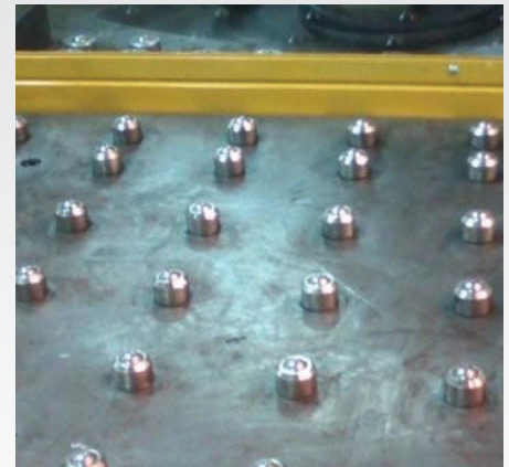
Die conveyor line 換模辅助设备
